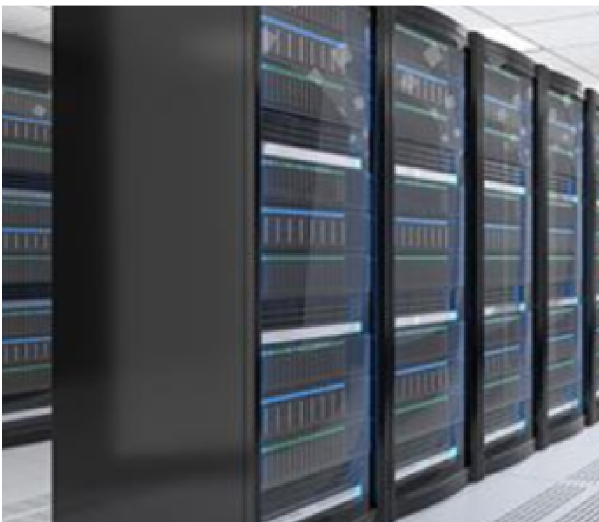
Datacenter Sede Principal
